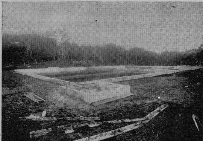
Hermoso tanque de sedimentación de la nueva cañería de Limón. Con este tanque han sido completadas las obras de mejoramiento que se llevaban a cabo en nuestro puerto del Atlántico
